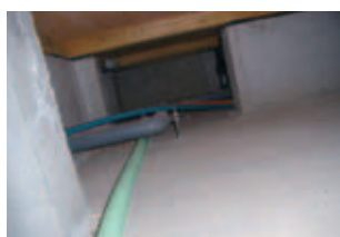
床下での基礎の欠損の確認
