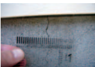
基礎のひび割れ幅が 過大でないか確認
